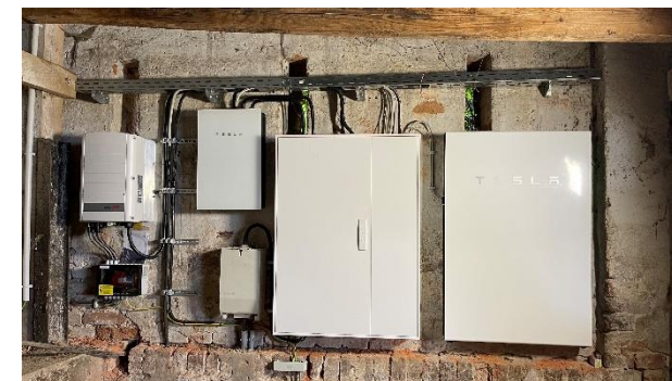
Elektroinstallation und Batteriespeicher PV-Anlage Arensnest
